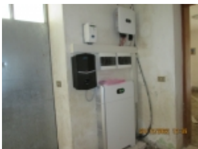
fotovoltaico con accumulo
